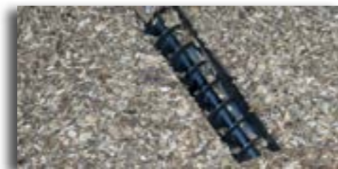
Vis d'alimentation de chaudière à bois déchiqueté
