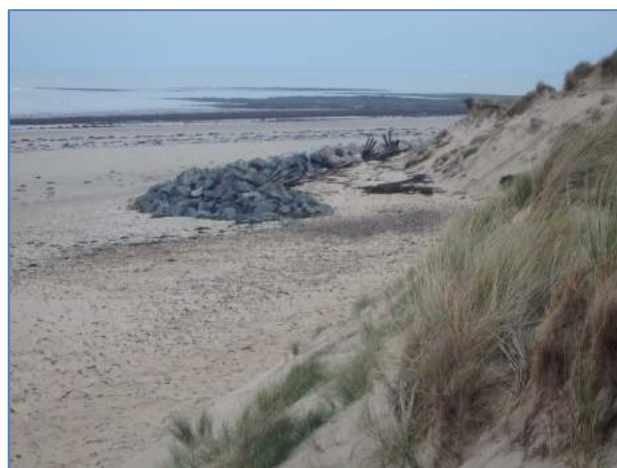
Etat de l'enrochement au 13/12/2021
