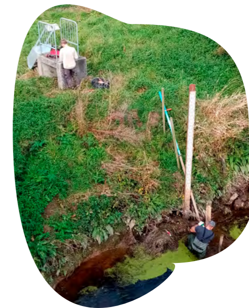
Installation d'une station de mesures sur la Vire
