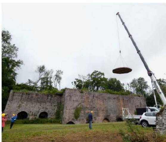
Une impressionnante opération sur le site des fours à chaux à Cavigny: la pose d'un couvercle sur l'un des gueulards afin de préserver l'intérieur des fours colonisés par des chauves-souris. Sébastien FROST/ICP
