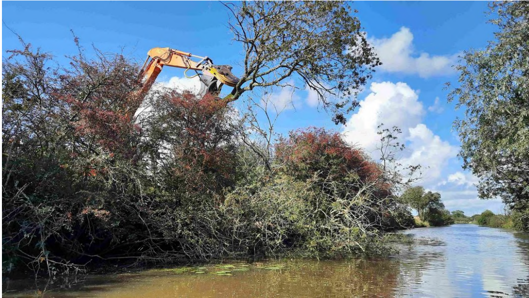
Gestion des embâcles sur la Jourdan, ENS des Ponts d'Ouve © A. Herouard
